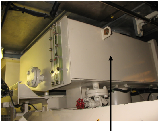
Abbildung 4.2.1: Ölausdehnungsgefäß oberhalb des Transformators
