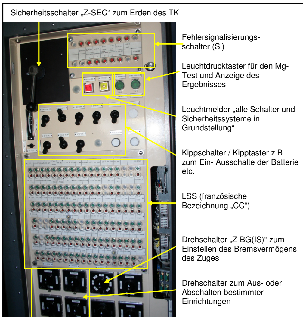
Abbildung 2.11: Ausschnitt oberer Teil des zentralen Schaltschranks an der Führerraumrückwand
