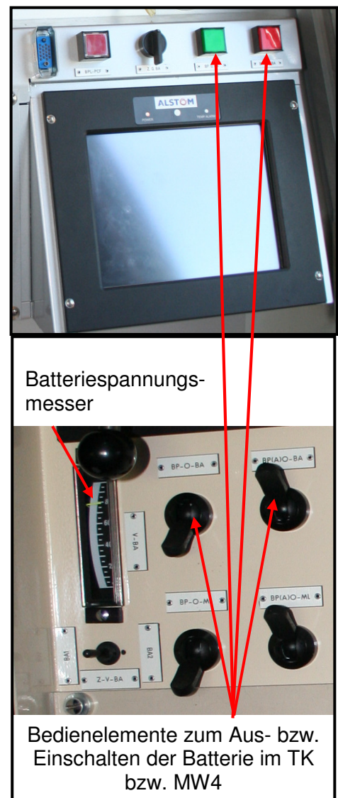
Abbildung 4.5.2: (Oben) Zub-Abteil (unten) Zentrale Schalttafel im TK
