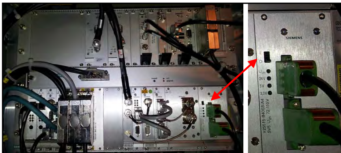
Abbildung 2-3: ETCS-Fahrzeuggerät mit Schiebeschalter zur Freigabe der SVG des EVC
