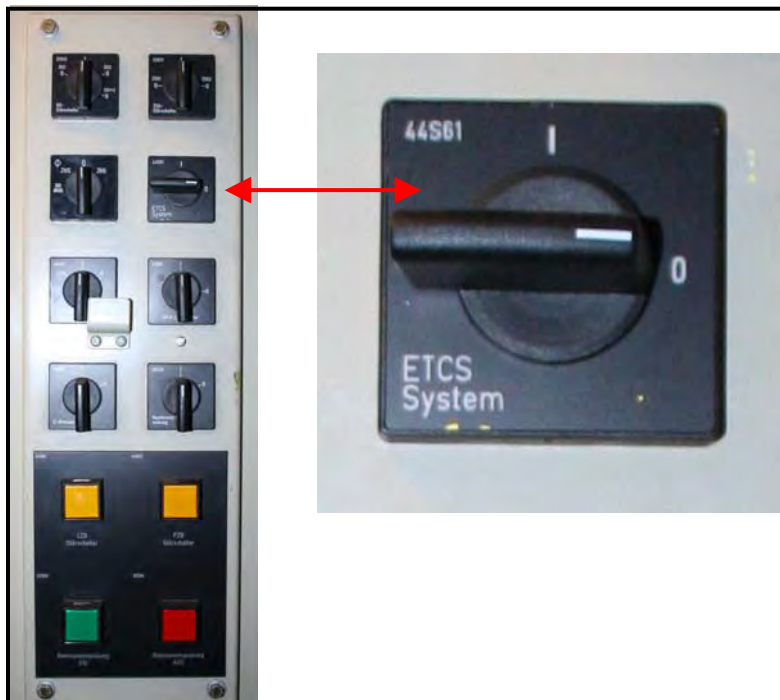
Abbildung 3-4-3.1: Störschalter „ETCS System“ an der Störschaltablet im Maschinenraum
