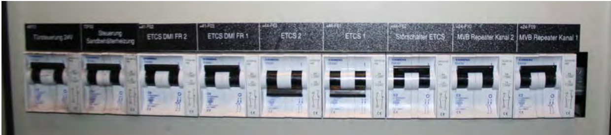
Abbildung 3-9.1: Neue LSS für die ETCS-Fahrzeugeinrichtung an der LSS-Tafel im Maschinenraum
